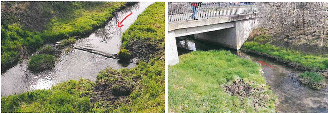
Foto 26-27: Reste eines alten Querbauwerks, Ufererosion und die Brücke Dorfstraße über die Gramme
