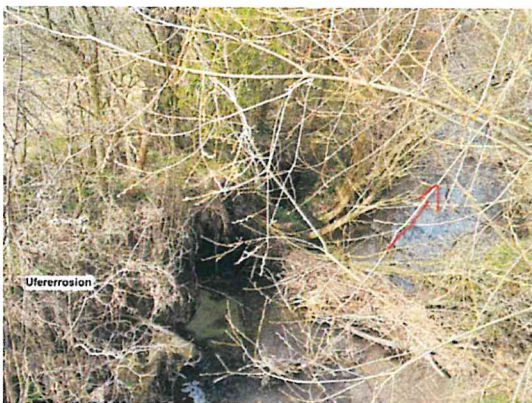
Foto 19 Erosionsschaden am linken Bachufer
